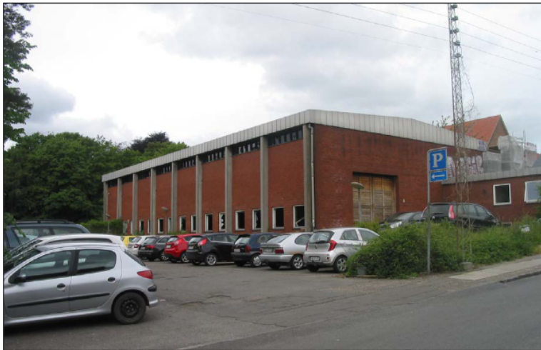
Kedelhuset. Bemærk de manglende eller knuste ruder.
