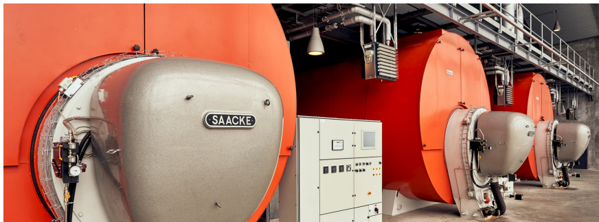
Kedelanlæg på Frederiksberg
